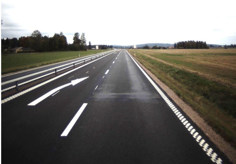
Figur 50 Bild från distans 630 meter. På höger sida finns en ansamling av bitumen i ytan.
