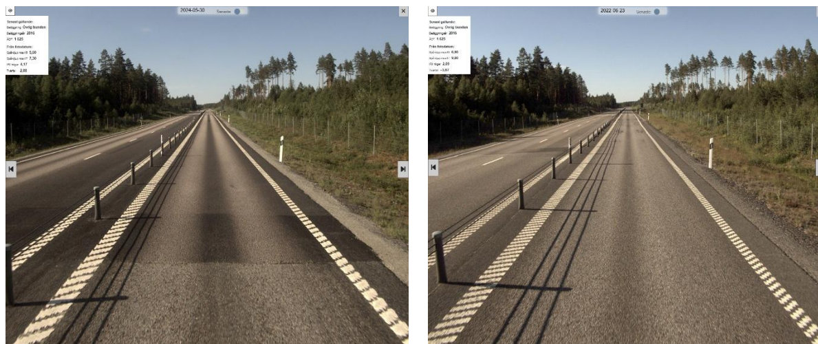
Figur 19 Bilder från mätning 2024 (till vänster) och 2022 (till höger). Vägen har lagats (mörkt parti) vid mätningen 2024. Källa: Trafikverket, PMSv4.
