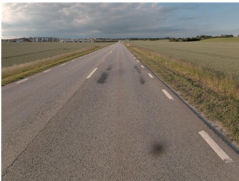
Figur 12 Sträcka på länsväg 108 med åldrad beläggning och stensläpp.
